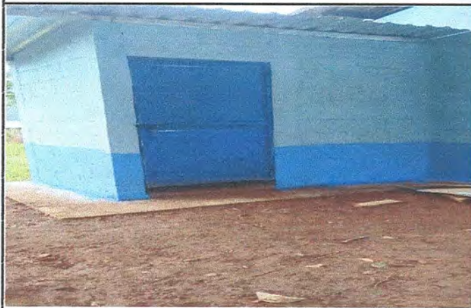
Foto 3: ESTADO ACTUAL DEL BAÑO
